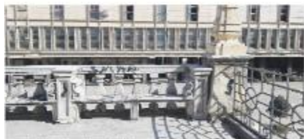
Le condizioni in cui versa la balaustra dopo l'atto vandalico
